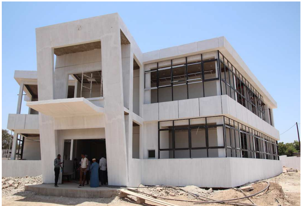
Photo 1 : Espace numérique ouvert (ENO) dont la construction est la plus avancée, au 13 mai 2017 (Kolda).
